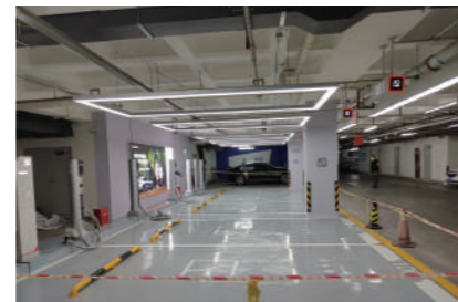
▲ 新兴广场ZEEKR Power超充站
