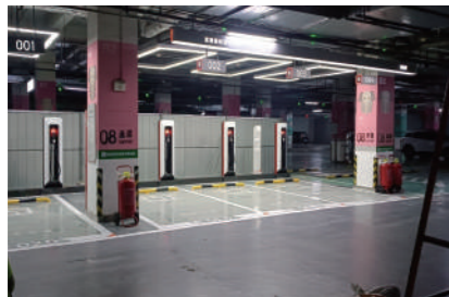
▲ 廊坊ZEEKR Power超充站
