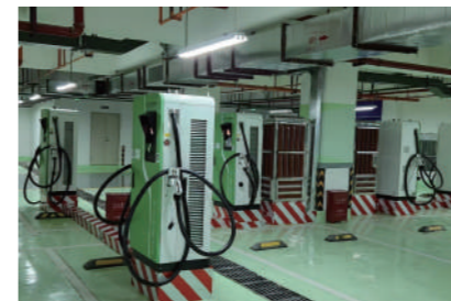
▲ 安宁市整区充电设施项目
