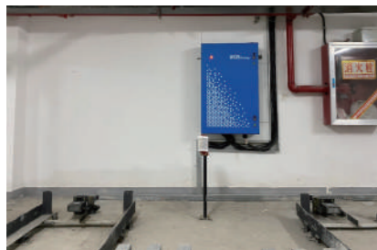
▲ 西安铁路局立体车库充电项目
