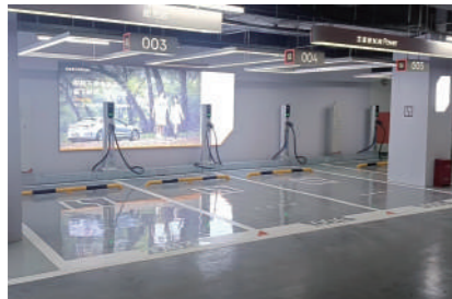
▲ 北京锦荟港ZEEKR Power超充站
